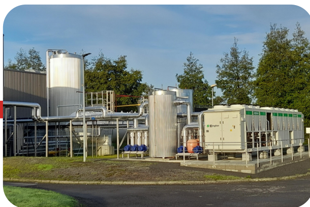
Les installations sur le site de Brient à Antrain (35).
